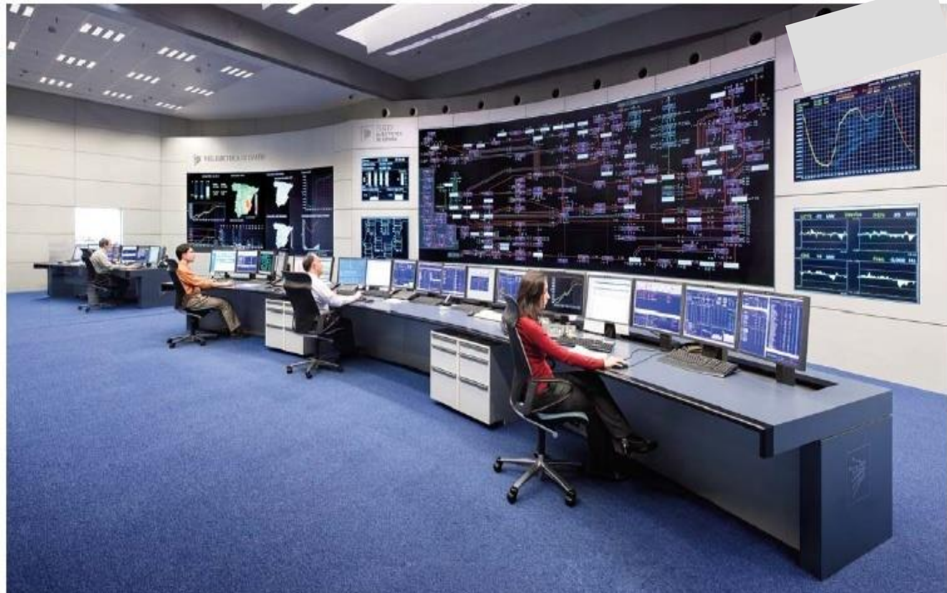
Centro de Control de un despacho de Cargas
