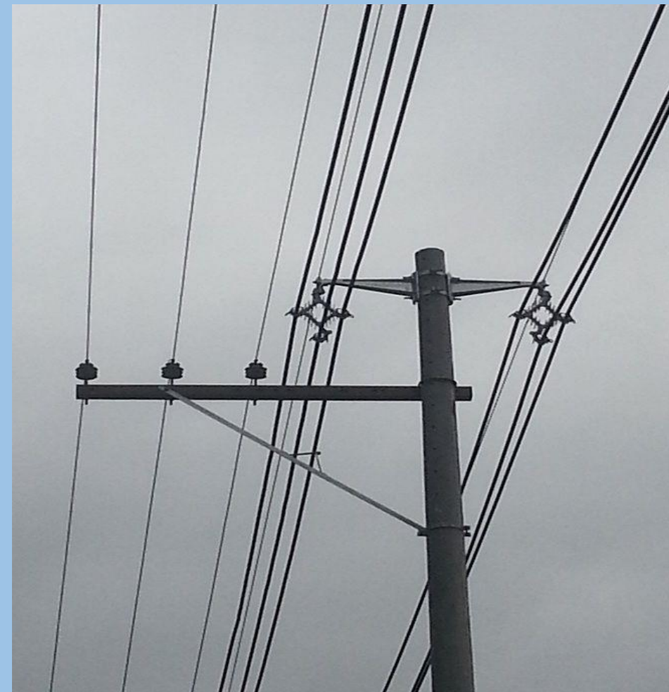
LINEA DE 13,2 KV DESNUDA Y PROYTEGIDA
