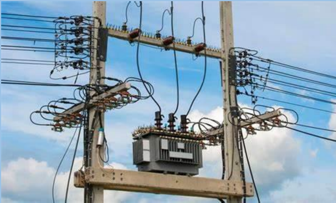
CENTRO DE DISTRIBUCION 13,2 KV/ 380-220 KV
