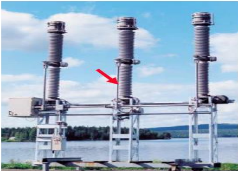
Interruptor-seccionador abierto/Puesto a tierra
