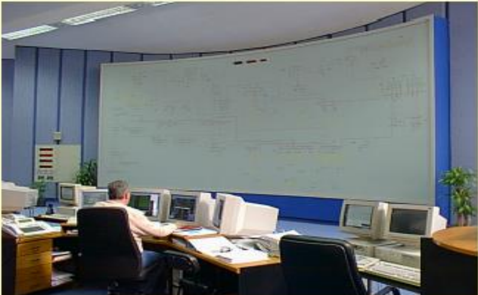
Centro de Control de un despacho de Cargas
